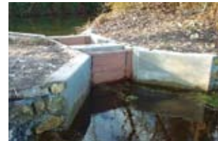
Ouvrage de régulation des niveaux d'eau
